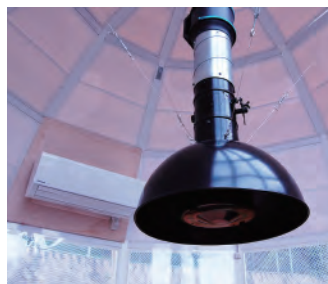
標準仕様のフード付換気ダクトとエアコン
